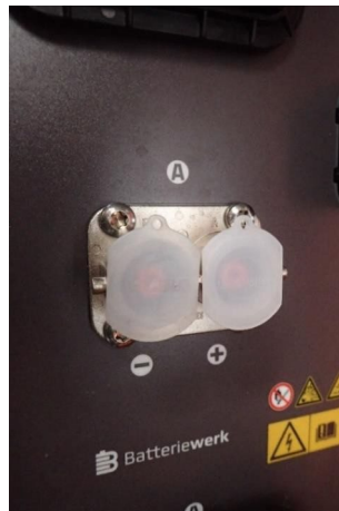
Abdeckungen an HV-Batterien
