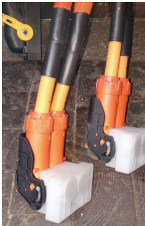
Couvertures sur les connecteurs HT
