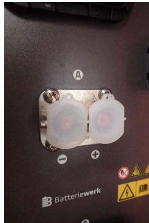
Couvertures sur les batteries HT
