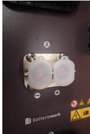
Coperture alle prese delle batterie-HV
